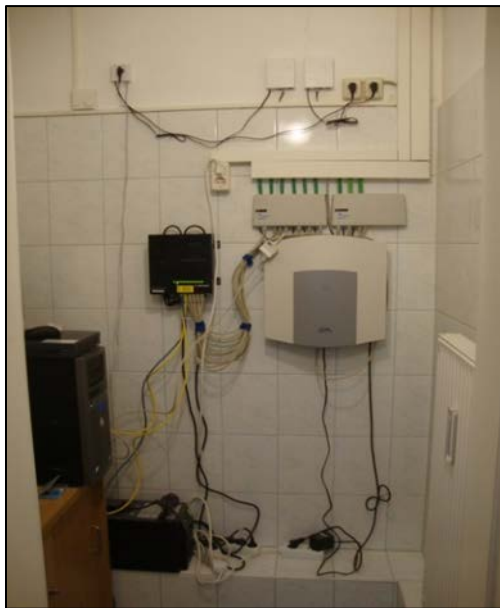
Abbildung 27: Dienstsitz C: Serverraum in Sanitäreinrichtung Quelle: Landesrechnungshof
