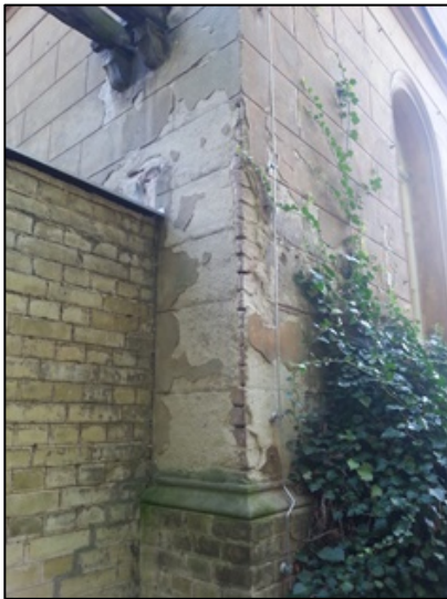
Abbildung 33: Foto zu Fassade Schäden an der Friedenskirche
