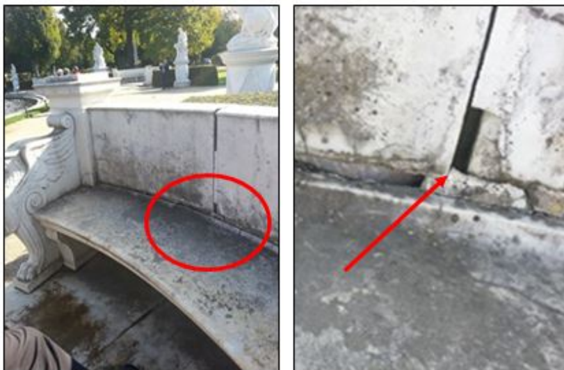
Abbildung 34: Fotos zu Schäden der Fugenverdichtung an den Römischen Bänken nahe der großen Fontäne
