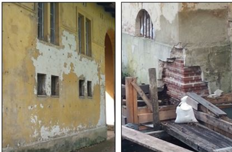
Abbildung 35: Fotos zu Fassade-schäden und brechendem Sockel der Maierie am Kuhtor
